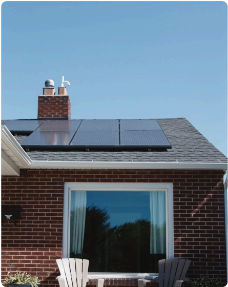
03 · 屋顶 屋顶光伏阵列
