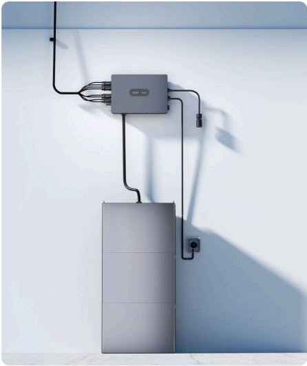
02 · 屋顶 屋顶光伏与储能
